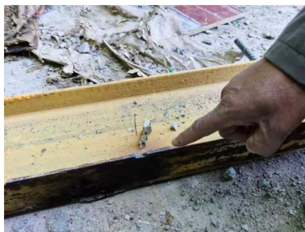
图六 工字钢的焊接点
